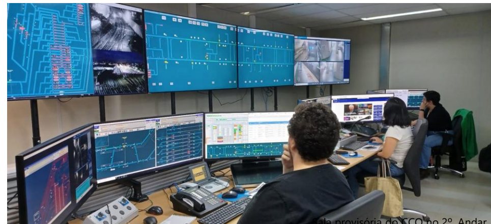
Sala provisória do CCO no 2º. Andar.
