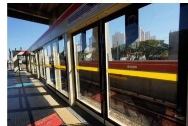
PORTAS DE PLATAFORMA DA ESTAÇÃO BELÉM
